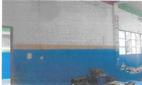
Foto 7: Aula 2, Elaboración de ventana de 2.05 de largo por 1 metro de alto, con paletas de vidrio y estructura de aluminio
