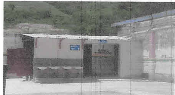
Foto 8: Sustitución de estructura de soporte de madera y lámina, por estructura metálica y lámina troquelada aluzinc calibre 26 en área de baños.
