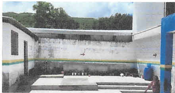
Foto 9: Instalación de galera estructura metálica y lámina troquelada aluzinc calibre 26 área de patio.
