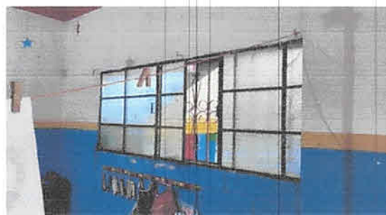
Foto 4: Aula 1, Sustitución de ventana de metal y vidrio por ventanas de paletas de vidrio y estructura de aluminio medida 2.25 de largo por 1 metro de alto.
